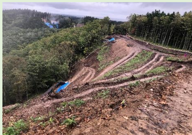
北見市常呂町風車建設道路の土砂崩れ現場
